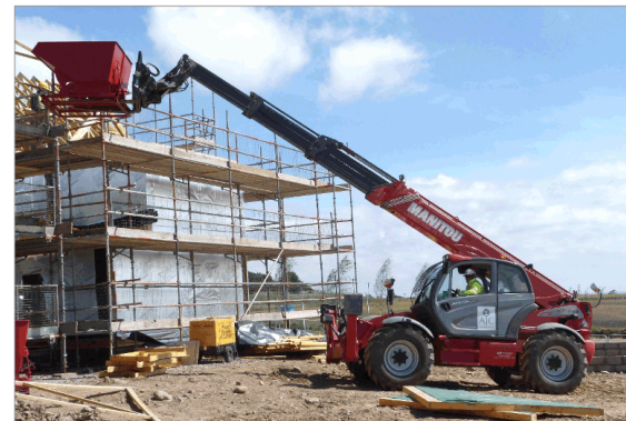
Keine Last im ausgefahrenen Zustand in den Kübel geben: Überlastungsgefahr!
